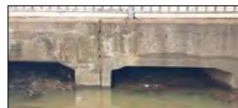
Die afvoerslote onder die brug was verstopt
