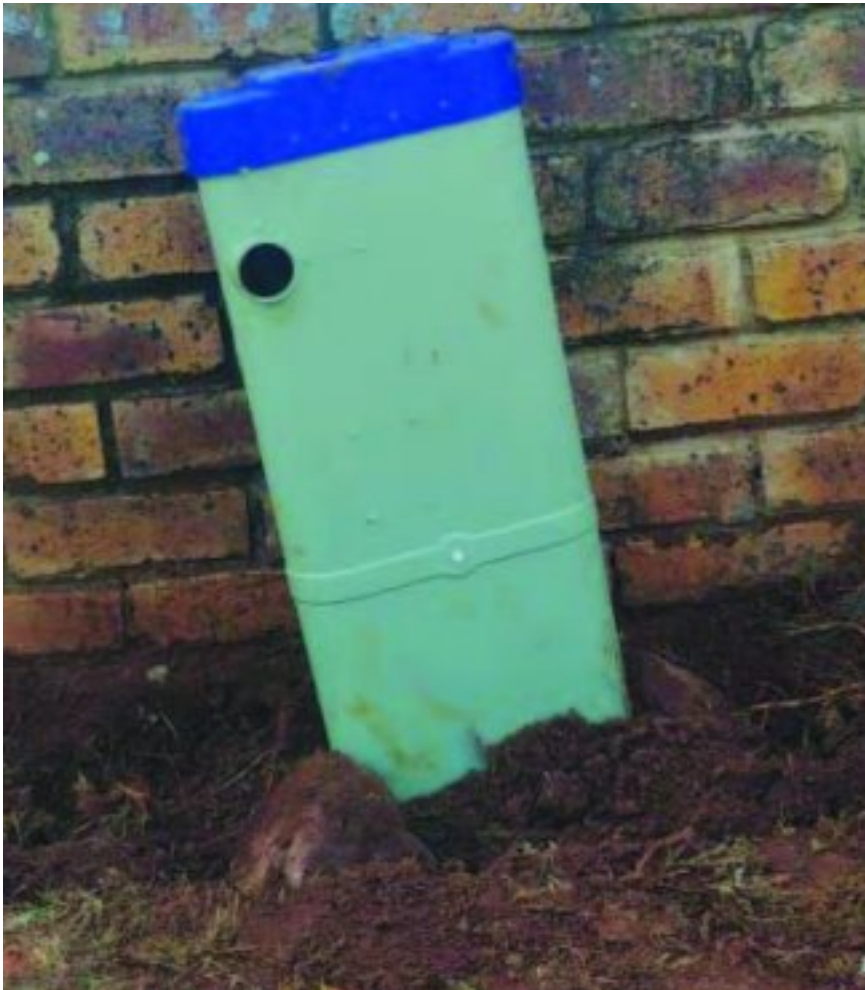
'n Skeef geïnstalleerde watermeter toon 'n weghollesing
